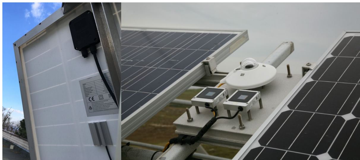
10.7 ábra a) Modulhőmérséklet mérő b) Időjárásálló kivitelű piranometer referenciacellákkal
